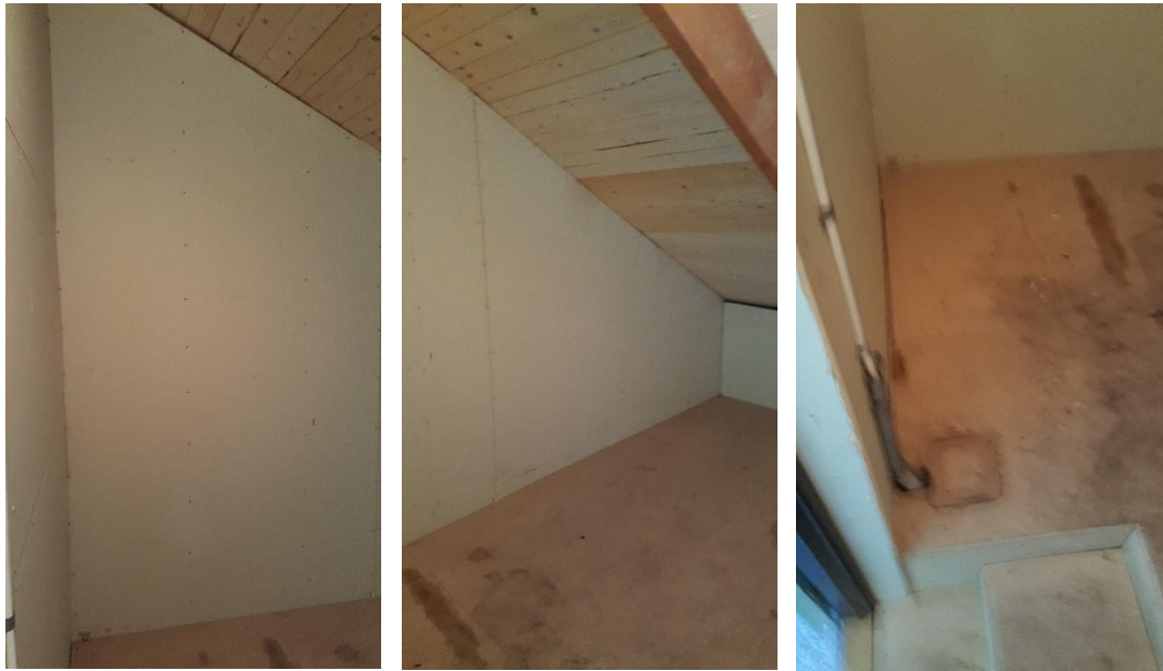
Figur 1: Vindsutrymme precis under taket och ovanför elrummet. På bilden till höger ses en befintlig genomföring till elrummet som eventuellt kan användas för AC-kablage.
