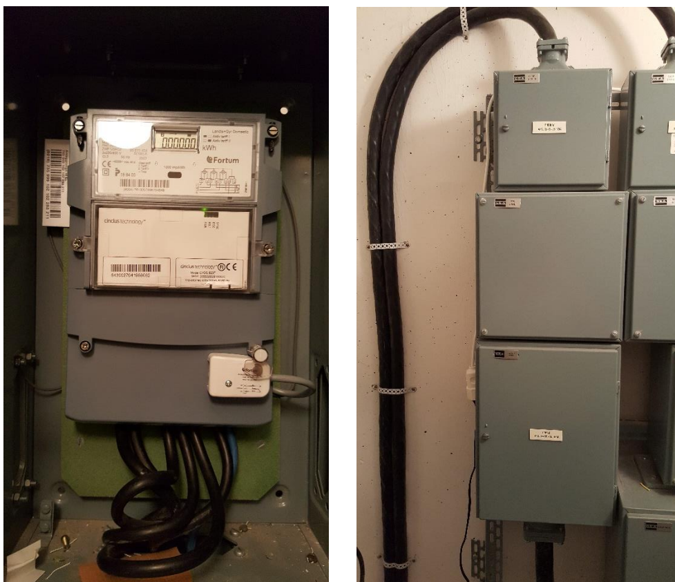
Figur 2: Elrum med elmätare och elcentral i en av fastigheterna. Liknande utformning återfinns i samtliga fastigheter.
